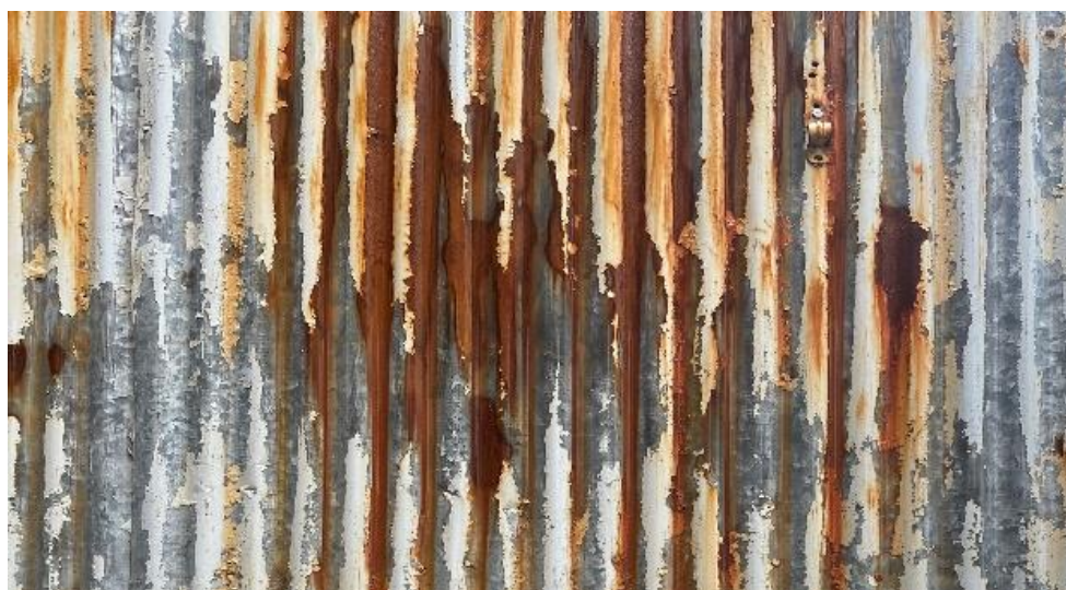
図9 トタンの錆と劣化の様子(筆者撮影)
