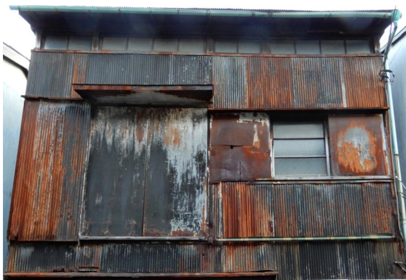
図7 外壁の補強材としてトタンを貼られた家屋(筆者撮影)
