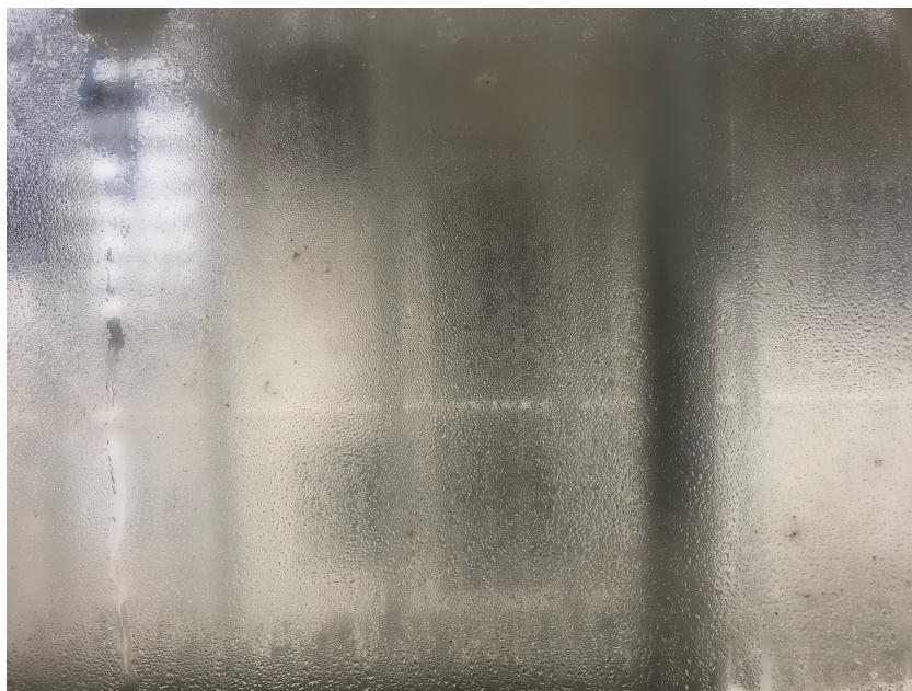
図9 結露した窓ガラス
